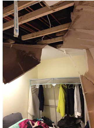
写真5 崩壊した部屋の天井
